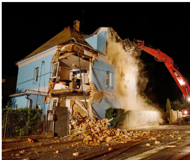
Rodinu libereckého strážníka Milana Šíra postihlo neštěstí. Rodinný dům ve čtvrti Františkov, kde bydleli, musel být stržen. Na domě byla stavební firmou prováděna rekonstrukce, při které došlo 14. září ke zřícení jeho části. Přivolaný statik následně rozhodl o definitivním stržení celého domu.
